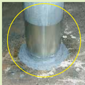
鋼製街灯地際部
