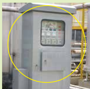
屋外制御盤外面
