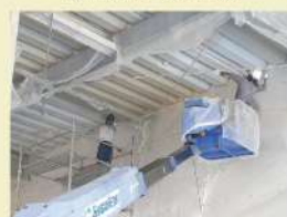
結露防止／鉄骨天井
